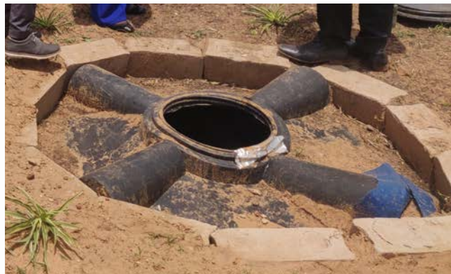
Réservoir de 3000L alimenté par une pompe et servant de fosse septique
